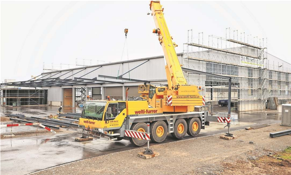
Bei der neuen Recycling-Oase wurde gestern das freitragende Vordach montiert. In der witterungsgeschützten Zone findet die kostenlose Entsorgung statt. CHRIS ISELI
